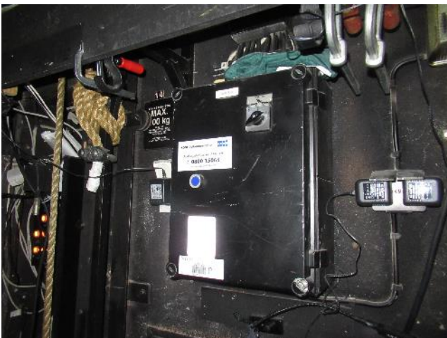
Teatterin palo-oven ohjauskeskus.
