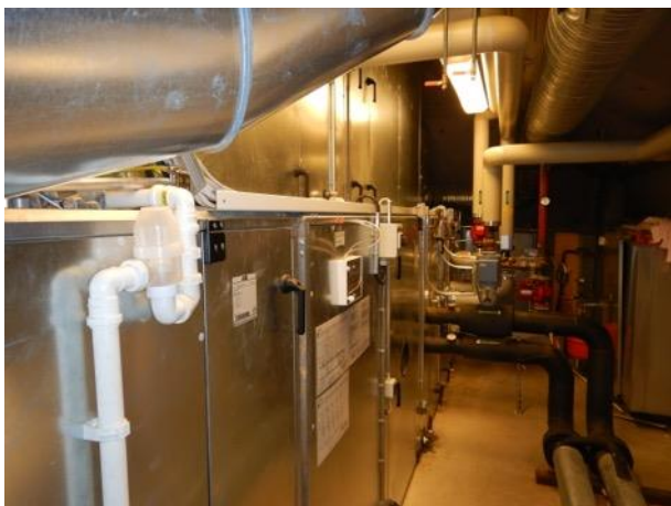
Yleiskuvat kiinteistön ilmanvaihtokoneista.
