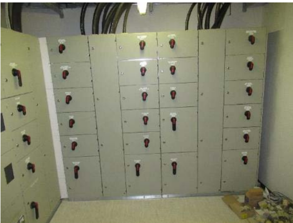
Yleiskuvat yhdestä IV-konehuoneesta, lämmönjakuhuoneesta ja sähköpääkeskuksesta.
