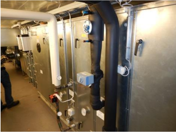
Yleiskuvat kiinteistön ilmanvaihtokoneista.
